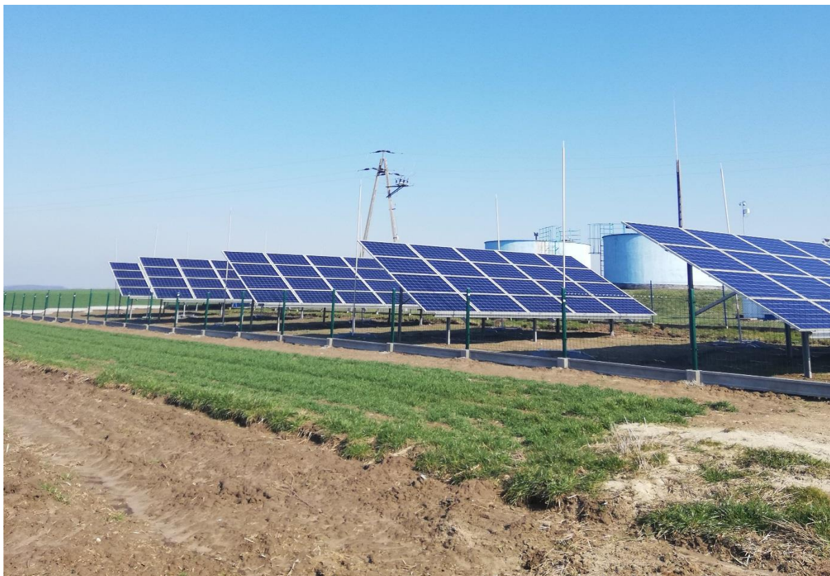
Zestaw instalacji fotowoltaicznej składający się z 142 szt. paneli fotowoltaicznych o mocy 39,60 kWp na budynku ujęcia wody w Tapinie. Wartość 237.562,20 zł brutto.
