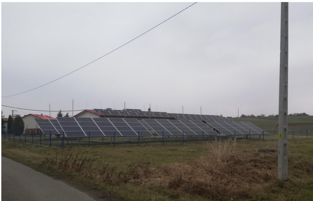
Zestaw instalacji fotowoltaicznej składający się z 142 szt. paneli fotowoltaicznych o mocy 39,60 kWp na budynku oczyszczalni ścieków w Rokietnicy wartość 238.052,97 zł. brutto.
