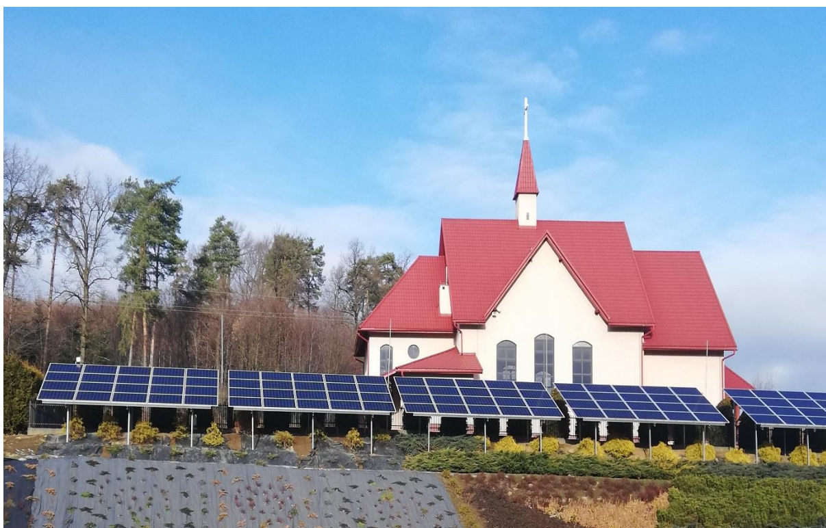
Zestaw instalacji fotowoltaicznej składający się z 95 szt. paneli fotowoltaicznych o mocy 26,40 kWp na budynku pompowni wody Rokietnica Wola. Wartość 162.652,74 zł brutto.
